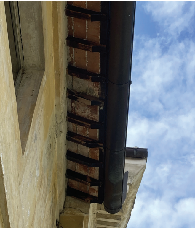
05. Villa Barbaro a Maser (TV), architettura storica monumentale, dettagli del prospetto in affaccio sul ninfeo: mancanza di efficacia del sistema di smaltimento delle acque meteoriche. Villa Barbaro a Maser (TV), historical monumental architecture, details of the front facing the nymphaeum: lack of effectiveness of the meteoric water disposal system. Greta Bruschi
