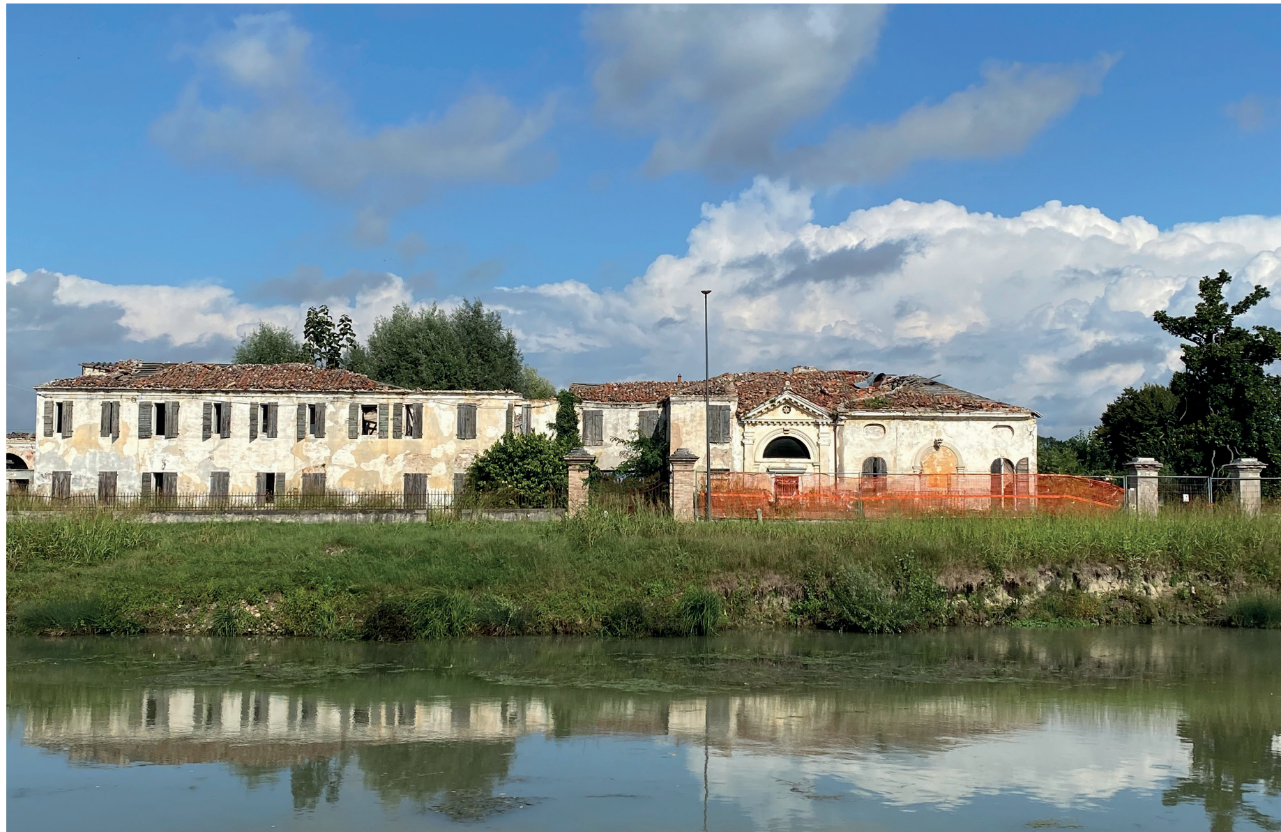
01. I danni al complesso di Villa Toderini-Fini-Piva a seguito del tornado del luglio 2015 in Riviera del Brenta (VE). Damage to the Villa Toderini-Fini-Piva following the tornado of July 2015 in Riviera del Brenta (VE). Greta Bruschi
