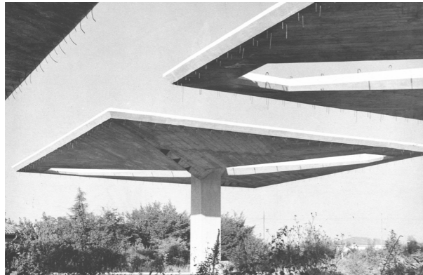
Marcello D'Olivo, Villaggio del Fanciullo a Trieste, 1950-55. Struttura a fungo della copertura della tipografia.
