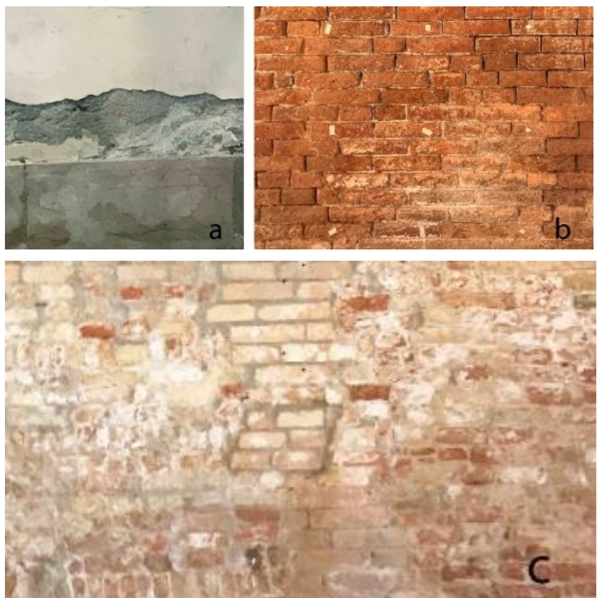
Figura 26. Dettaglio delle murature indagate degli edifici Veneziani. A) Terese, B) Tolentini, C) Cà Tron
