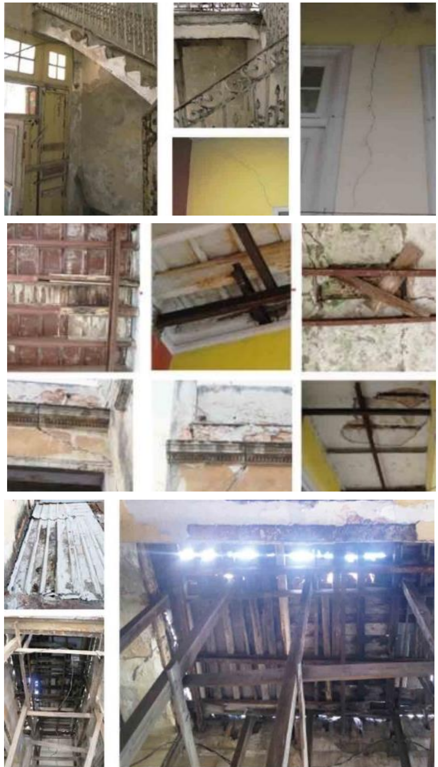
Figura 27 Rilievo del Danno nell'edificio Malecon 19
