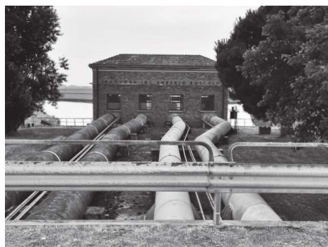
L'Idrovora Boscolo è situata a due chilometri oltre il centro abitato di Polesine Camerini, a ridosso dell'argine della Sacca del Canarin, a poca distanza della centrale termoelettrica dell'Enel.
