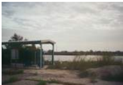
Etang de Berre. Una pompa idraulica per il controllo delle acque del Canale Caronte. Camilla Cangiotti, 2024.
