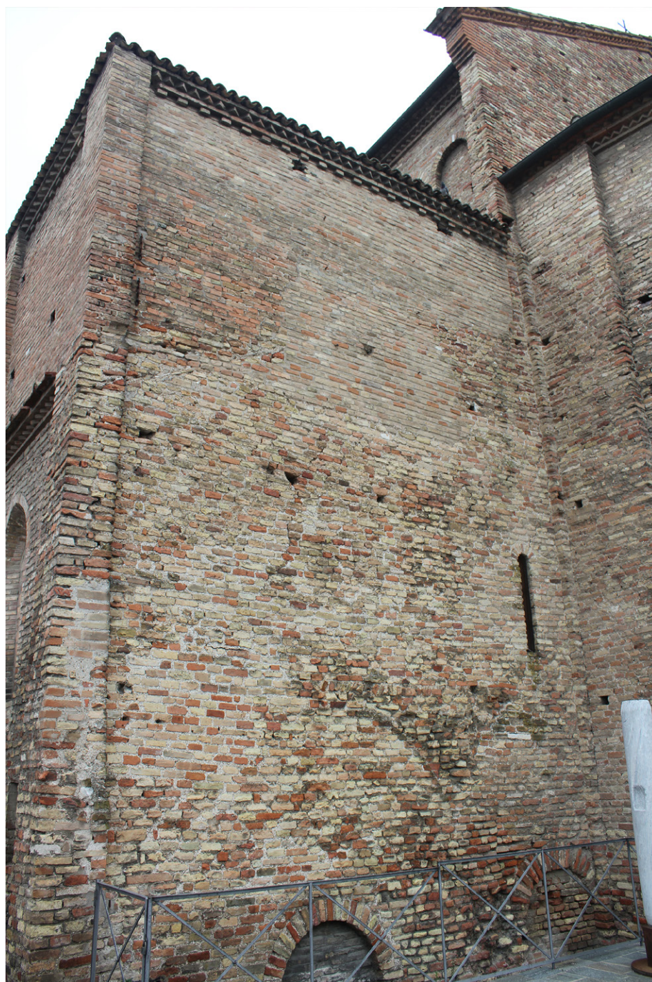
Fig. 5. Ravenna, San Pietro Maggiore (oggi San Francesco), la presenza di tecniche murarie differenti osservabili su uno stesso paramento consente di fare ipotesi su danni passati, interventi di ricostruzione e di proporre meccanismi possibili tenendo conto di abachi specifici contenuti nelle norme e della complessità della realtà costruita (foto I. Zamboni 2020).
