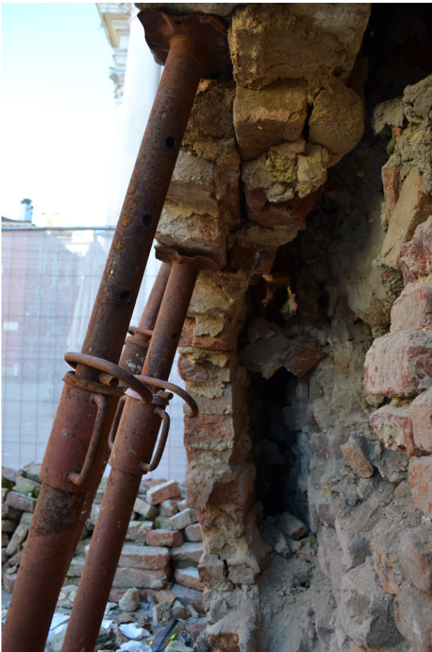
Fig. 3. Venezia, il dissesto mette in luce una sezione resistente ottenuta attraverso l'accostamento di paramenti distinti. La scarsità della qualità costruttiva, assieme al degrado della muratura, chiarisce il comportamento e indirizza l'intervento di miglioramento strutturale (foto I. Zamboni 2021).
