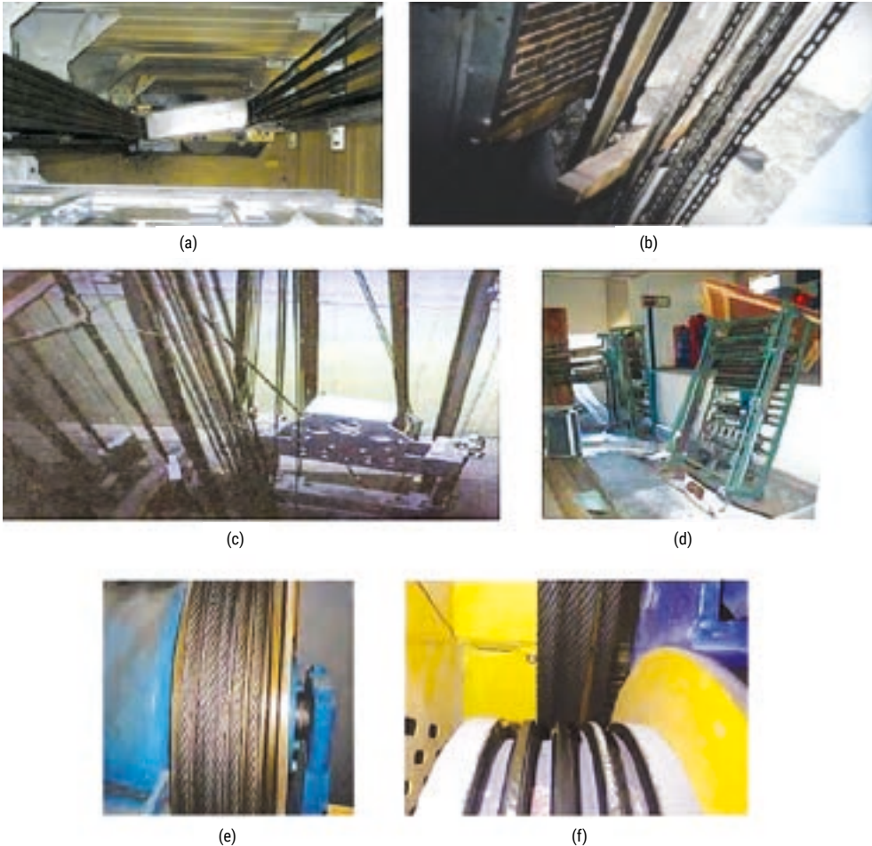
Fig.01 Esempi di danni: (a) deragliamenti del contrappeso [Tattoli, 2017]; (b) fuoriuscita dei blocchi di riempimento dal telaio [Tattoli, 2017]; (c) funi impigliate nelle parti fisse del vano [Tattoli, 2017]; (d) danni agli ancoraggi dei pannelli di controllo [Miranda et al. , 2012]; (e) accavallamento delle funi [Du, 2008]; (f) scarrucolamento delle funi dalle pulegge [Du, 2008].
