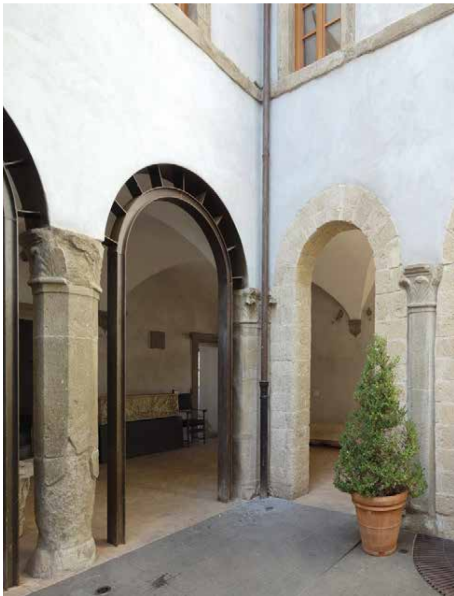
96. Palazzo Chigi , Formello, corte interna. Si notino sulla sinistra le strutture di consolidamento in acciaio progettate da Andrea Bruno e sulla destra la rifodera in blocchi di tufo risalente all'Ottocento. Ph. Giorgio Danesi, 2023.
