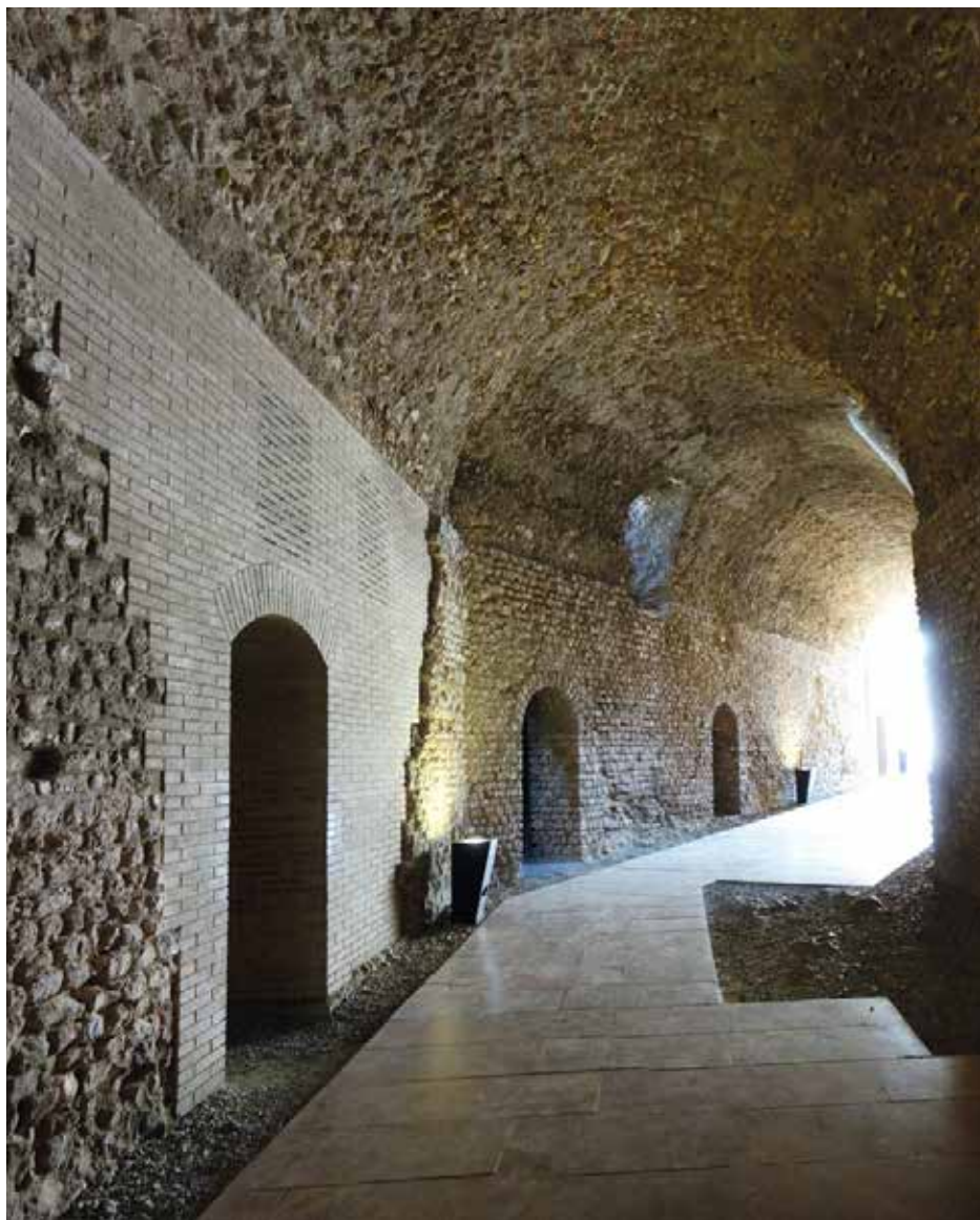
62. Circo romano di Tarragona , Spagna, la galleria di sostegno delle gradonate, oggi attraversata dal percorso museale. Si notino le integrazioni di muratura distinguibili e sottosquadro, realizzate con mattoni che riprendono la colorazione della pietra locale. Ph. Giorgio Danesi, 2023.
