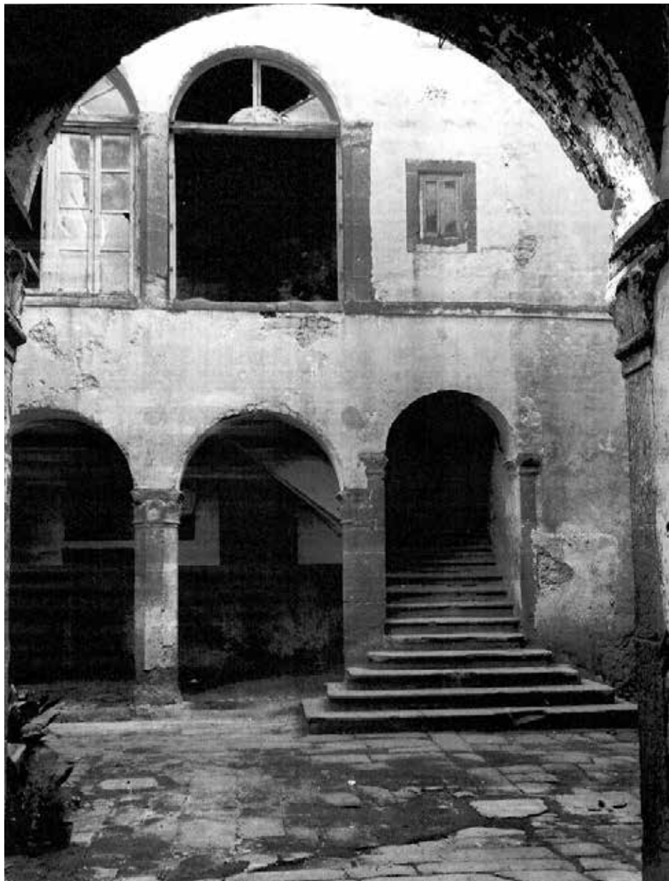
93. Palazzo Chigi , Formello, stato di fatto precedente all'intervento, ante 1999. Per gentile concessione dell'Archivio del Museo dell'Agro Veientano.
