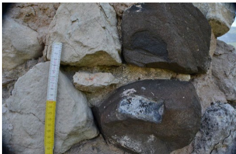
Fig. 5- Caso I. Composizione del giunto di connessura originario in calce aerea (foto di Isabella Zamboni, 2010).
