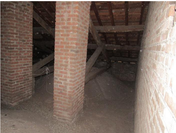
51. Carmine di Pavia, sottotetto della terza campata del collaterale nord, particolare degli estradossi delle volte delle cappelle. Si noti la prosecuzione senza soluzione di continuità del muro di spina.
