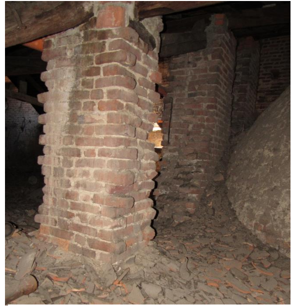
85. Carmine di Milano, sottotetto del collaterale sud; particolare di un sostegno alla carpenteria dei tetti, apparecchiato a pettine.
