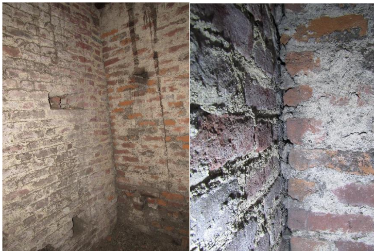
78. Carmine di Milano, sottotetto della navata maggiore. Innesto del transetto sud e particolare della muratura in appoggio.
