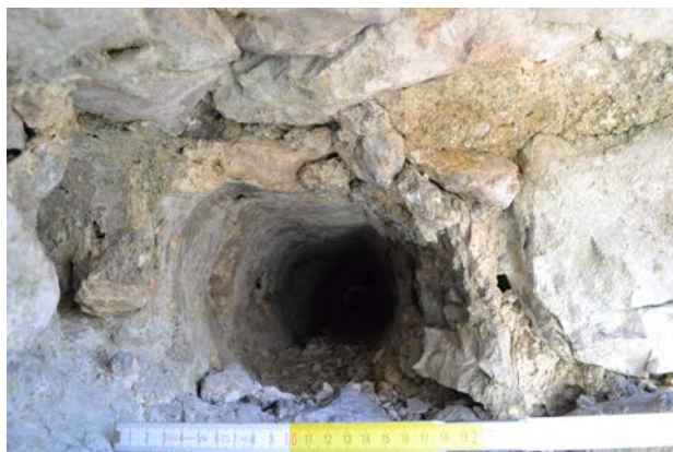
Figura 10: Castel Barco, Pomarolo (TN). Sezione della cinta sommitale con le tracce lasciate dal sistema di rinforzo ligneo con travi a sezione circolare. Particolare.
