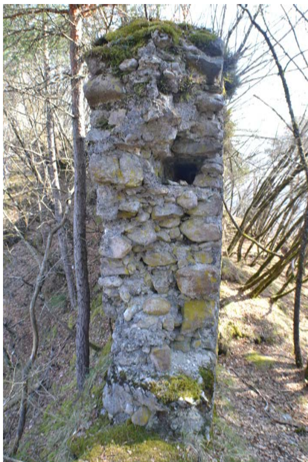
Figura 15: Castel Flavon, Flavon (TN). Sezione del muro di cinta dove permane traccia di una trave a sezione rettangolare disposta longitudinalmente alla sezione.
