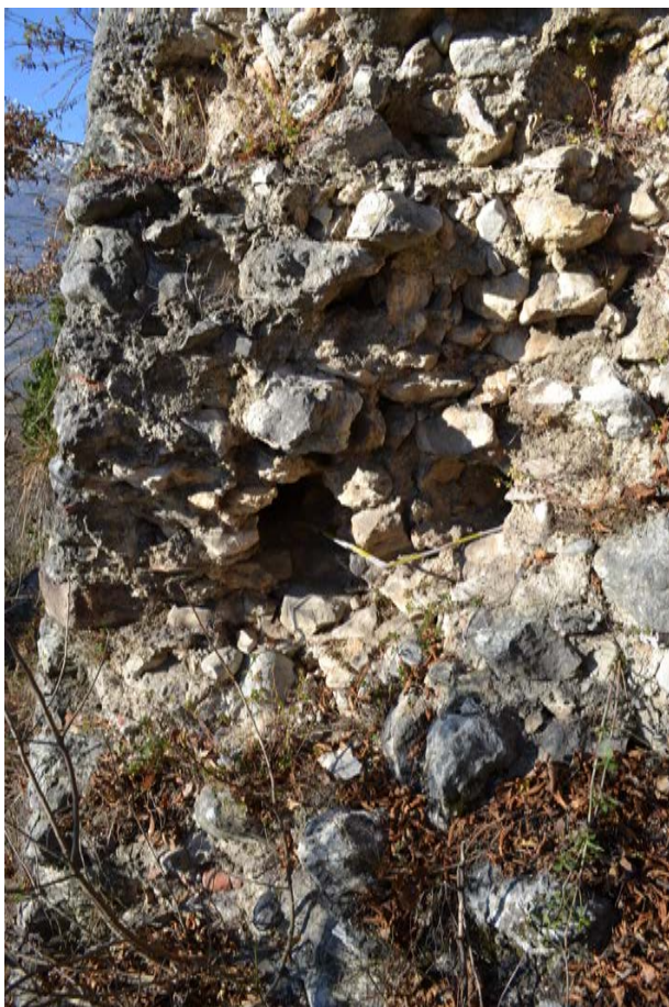
Figura 8: Castel Barco, Pomarolo (TN). Sezione della cinta sommitale con le tracce lasciate dal sistema di rinforzo ligneo con travi a sezione circolare.
