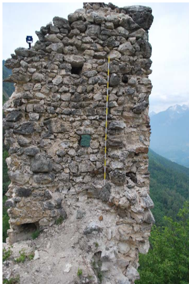
Figura 18: Castel San Pietro, Vigo di Ton (TN). Sezione dell'edificio addossato alla prima cinta che presenta conservate in situ travi a sezione circolare ad intervallo di 1,5 m.
