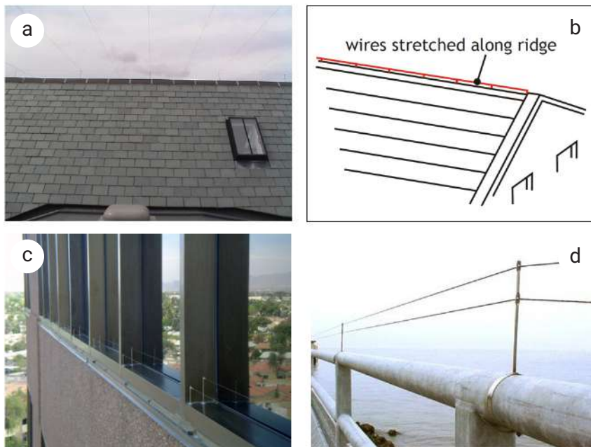
Figura 11. Esempi di installazione di fili ballerini (bird wires) su tetti (a e b) e parapetti (c) degli edifici ed altre strutture (d) tipicamente utilizzate dai gabbiani come posatoi (ad es. corrimani dei ponti). Fonti delle immagini a) https://www.ecoltd.net/seagull-deterrents ; b) Gloucester City Council 2005; c e d) Pacific Grove, CA ( cityofpacificgrove.org ) (data di accesso 29/08/2022).
