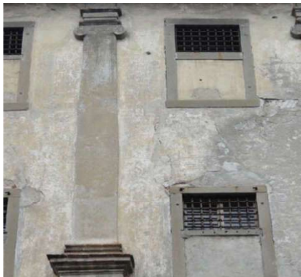
7: Il carattere complesso acquisito è a tratti contraddittorio come rivela il contrasto fra i resti degli intonaci dipinti dell'ordine gigante ionico che scandisce l'architettura del cortile e le modifiche di adattamento degli ambienti interni a celle di detenzione.
