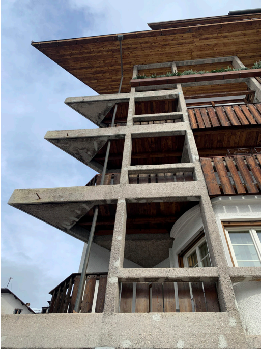
fig. 3. Casa Giavi in Cortina (E. Gellner, 1954-55). Wood and concrete decay. (© Sara Di Resta, 2019)
