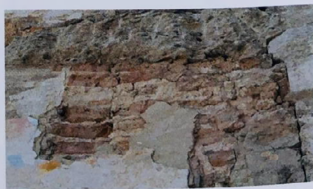
Fig. 15- Interfaccia di demolizione di una parete perpendicolare alla facciata, che fa parte del tamponamento dell'arco
