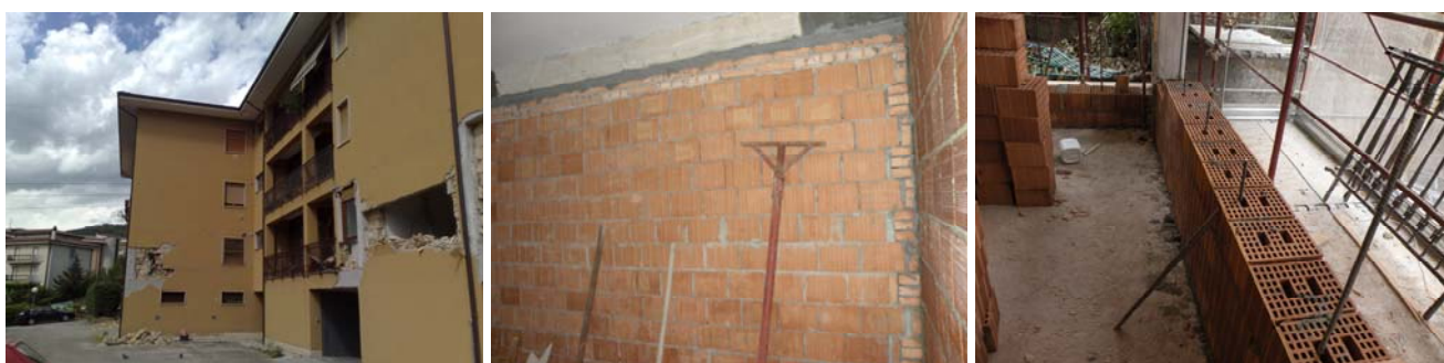
Figura 3 – Palazzina Vittorini, a L'Aquila, fortemente danneggiata dal terremoto del 2009. La struttura è stata trasformata da telaio in CA a esoscheletro ed endoscheletro in muratura armata. I tamponamenti e i tramezzi, che erano danneggiati e quindi da sostituire, sono stati rimpiazzati, anziché con componenti analoghi, con elementi strutturali (Poroton armato) progettati per portare tutti i carichi verticali e l'azione sismica. Al centro: serraggio di ciascun campo di telaio con mattoni a elevata resistenza e rigidità, e malta di cemento espansivo, lungo i lati verticali e il bordo superiore, a contrasto con le travi e i pilastri esistenti.
