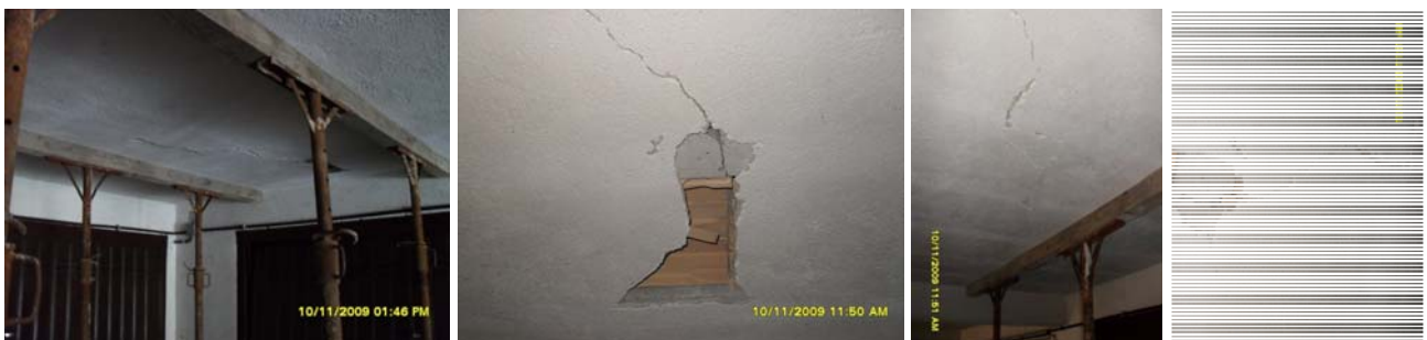
Figura 5 – Solaio in laterocemento al primo piano di un edificio a L'Aquila, danneggiato dal sisma del 2009. Il funzionamento a piano rigido ne ha provocato una fessura diagonale passante, che lo ha reso labile nel piano. Dalla fessurazione in poi, quel solaio e gli altri analogamente fessurati hanno cessato di lavorare nel piano.
