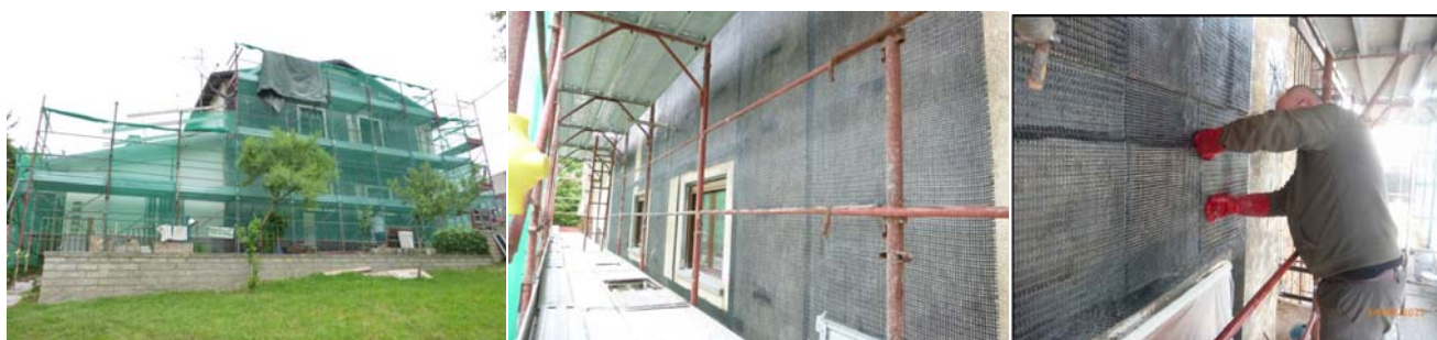
Figura 2 – Sinistra e centro: edificio ad Amatrice (Rieti), danneggiato dalla sequenza sismica del Centro Italia del 2016-2017. Destra: edificio a Brescia, migliorato sismicamente. Rinforzi in FRP a fibra di carbonio applicati sulle pareti murarie perimetrali con connettori trasversali infissi nelle pareti. Il rinforzo ha realizzato un esoscheletro in muratura armata, progettato per portare l'azione sismica. Ad Amatrice, le pareti erano danneggiate in misura moderata ed è stato possibile ripararle. A Brescia, i laterizi dei tamponamenti sono stati provati in laboratorio così da definirne le caratteristiche meccaniche.
