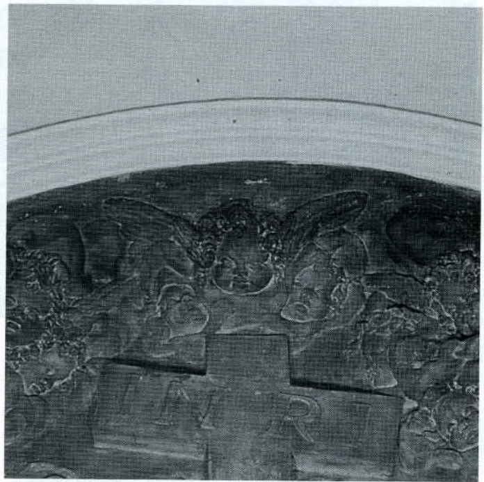
FIG. 8 Presenza dello strato di nero-fumo sulla superficie del sottarco.
