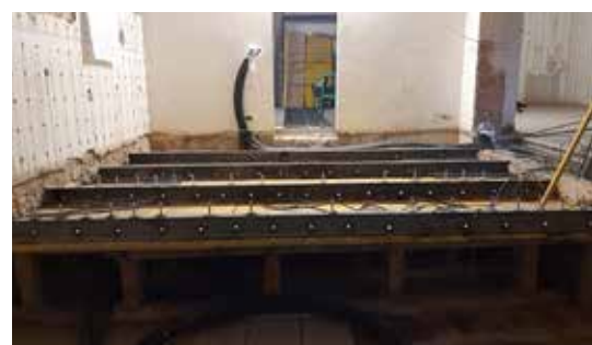
IN ALTO_Vista del tirante-capriata. SOPRA_Solaio di un corridoio del primo livello durante i lavori.
