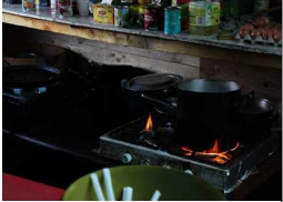
RESTAURANTS MUNIS DE CUISINIÈRE AU GAZ
