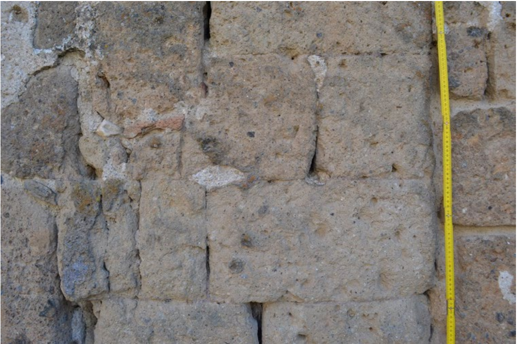
3: Isabella Zamboni, Prospetto esterno nord della torre medievale con tecnica in opera quadrata in lapides ad filum , 2016.
