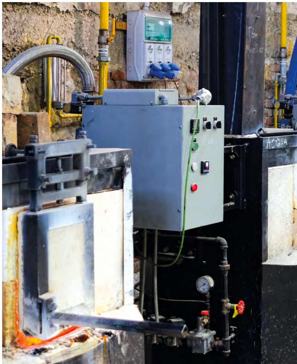
Wave Murano Glass. Forni a efficienza energetica. Ph. Ruggero Perenzin, 2025.
