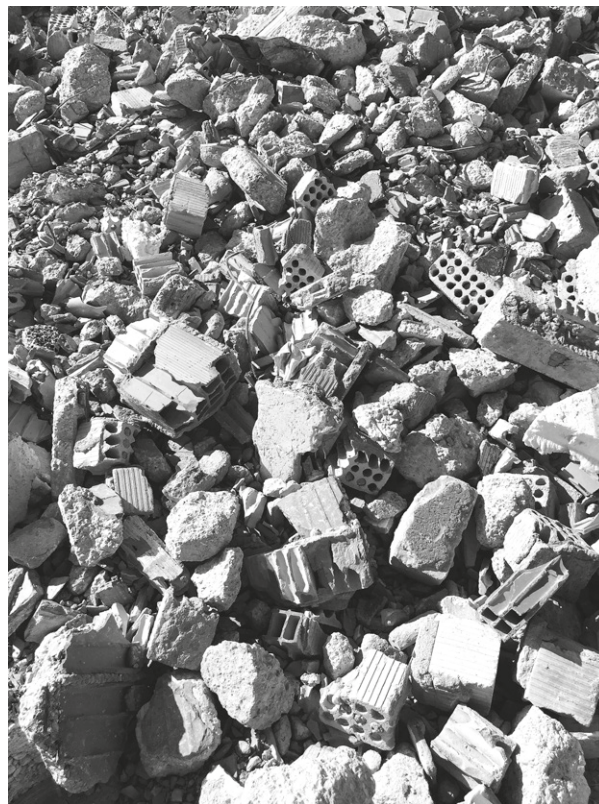
02. Materiale di risulta del cantiere di demolizione delle palazzine di via Anelli a Padova | Waste material from the demolition site of the buildings in Via Anelli in Padua. Chiara Scanagatta
