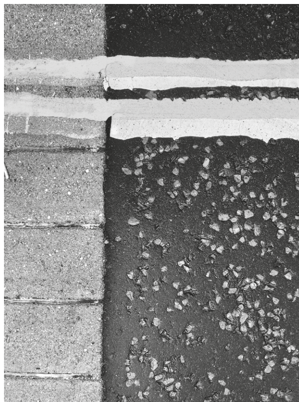
03. Manto stradale realizzato con inerti in laterizio derivanti dalla demolizione delle preesistenti case popolari in Mawson Road a Manchester | Road surface made of brick aggregates collected from the demolition of social houses in Mawson Road in Manchester. Chiara Scanagatta
