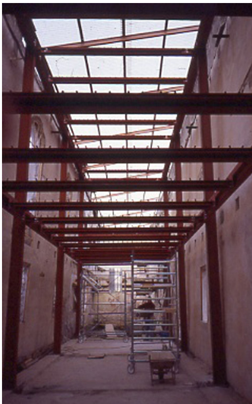
Fig. 4. E. Vassallo, P. Grandinetti: Foresterie Vecchie di villa Contarini Simes a Piazzola sul Brenta (PD). Il collegamento tra muratura e carpenteria della nuova struttura in acciaio è realizzato mediante la disposizione di un giunto a cedimento controllato che consente piccole rotazioni e cedimenti verticali (foto E. Vassallo).
