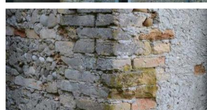
4. Angolo dell'edificio rurale con mattoni rotti
