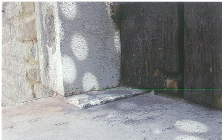
Figura 7 - Canonica della chiesa della Bragora, fronte su campiello del Piovan. Foto di dettaglio del risalto sul davanzale all'appoggio delle spalle delle finestre del primo piano. Foto di F. Trovò, 2012. Per gentile concessione dell'architetto Francesca Semenzato.
