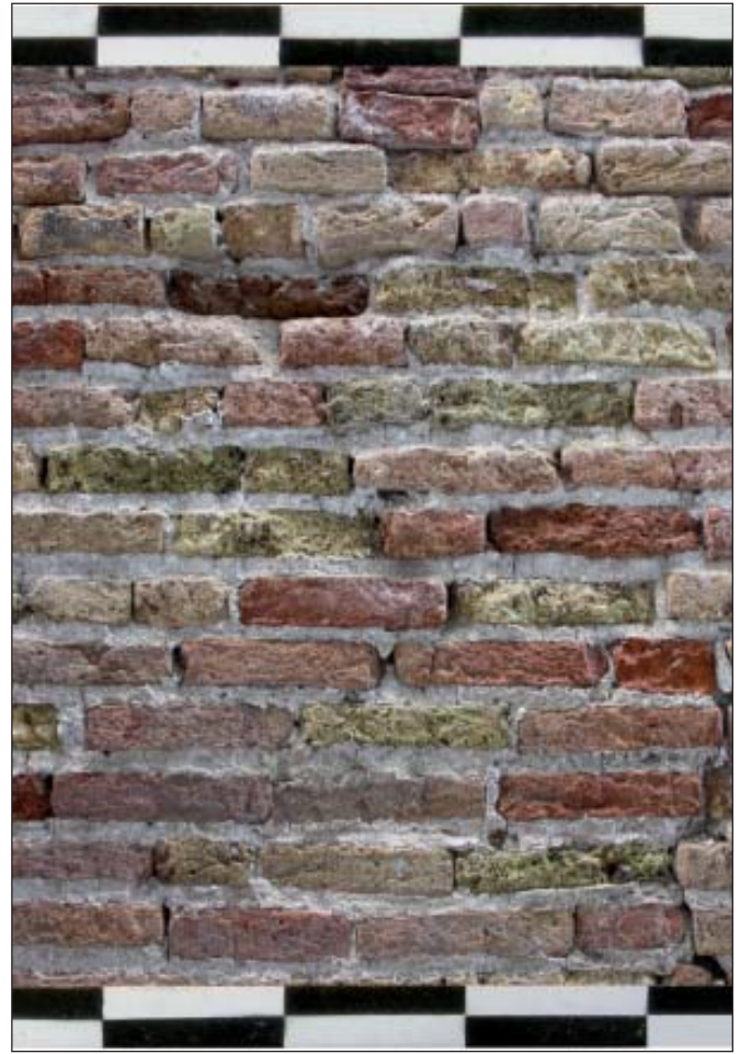
Fig. 6. Campione di muratura con mattoni eterogenei a spessore ridotto e lunghezza variabile, con giunto di spessore maggiore di cm 2 (Edificio in calle Astori, S.Polo)
