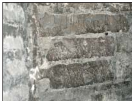
Fig.14. Venezia, campanile di S.Geremia: mattone romano rilavorato a scalpello. Lavorazioni a mattone cotto caratterizzano il periodo più antico, basato sul reimpiego, in cui i materiali venivano rilavorati a martellina o mediante scalpellatura e successiva rifinitura-limatura
