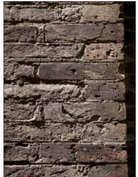
Fig. 16. Lavorazioni complementari: graffiatura associata a molatura nei contrafforti della chiesa dei Carmini, con mattoni gotici trattati ad olio e giunto stilato
