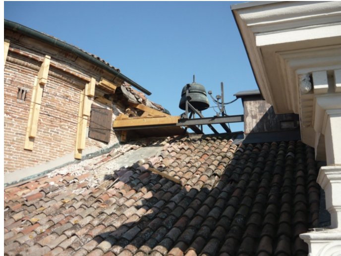
Figura n° 31: i crolli del tamburo dell'aula dei fedeli causati dal "martellamento" delle putrelle sulle superfici di incastro. In evidenza le opere provvisorie realizzate dal Vigili del Fuoco SAF.
