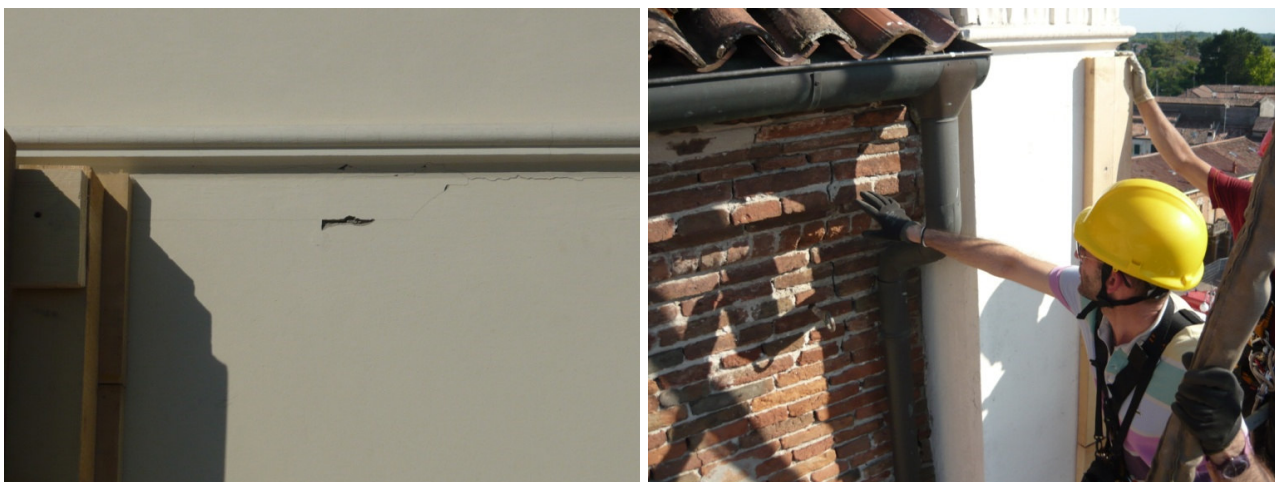
Figura n° 29 - 30: la lesione in facciata e la verifica diretta effettuato sull'edificio in fase emergenziale post sisma.
