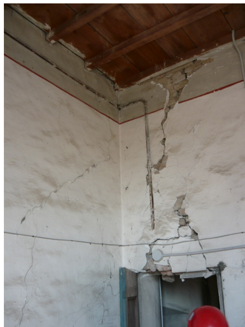
Figura n° 32: stanze poste al primo livello della chiesa addossate alla muratura prospettica primitiva. Evidente e importante il quadro fessurativo con collasso della piattabanda della porta. Significative sono le lesioni sulle strutture murarie collegate alla facciata originaria rispetto a quelle registrate alla nuova pelle prospettica convalidando la tesi delle due facciate binate sollecitate dal sisma in maniera differente l'una dall'altra.
