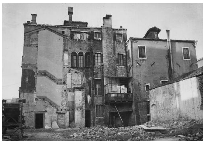
Figg. 10-11. Venezia. Palazzo Adoldo, le opere di messa in sicurezza della facciata e la demolizione del corpo aggiunto (IUAV, AP, FFT, Forlati 2.1 Progetti e concorsi/045).
