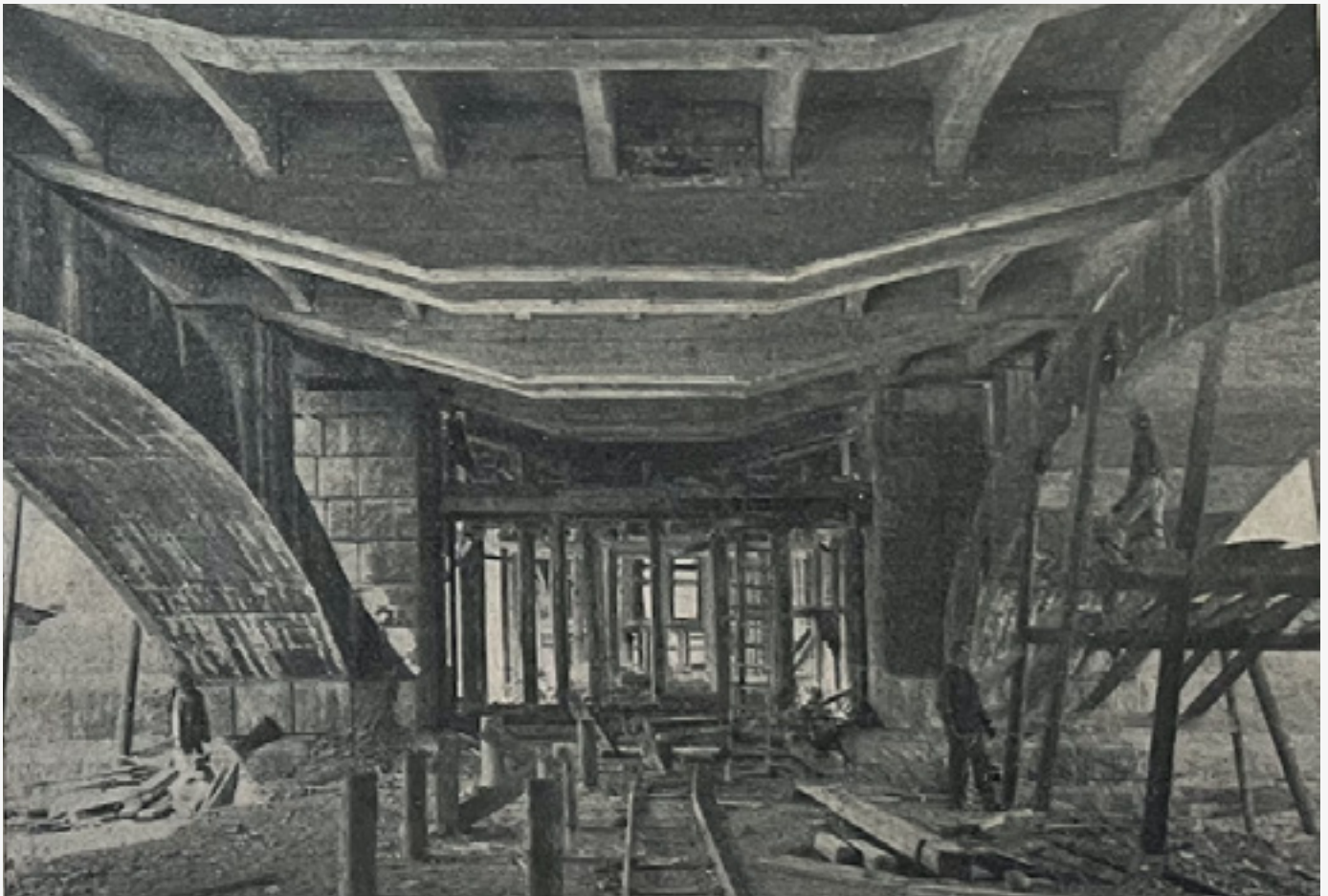
fig.79 Fotografia delle travature d'impalcato in cemento armato del ponte Druso. AP IUAV, Miozzi 2.fot/35
