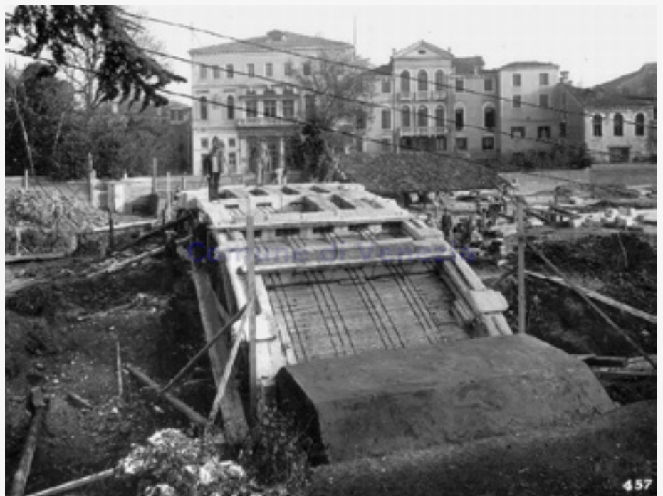
fig.198 Ponte del Prefetto in costruzione, i quindici tiranti in opera al momento della costruzione della volta. In primo piano, il plinto di fondazione in cemento armato. AMV Celestia, Archivio Storico Giacomelli , inventario n°GN000692
