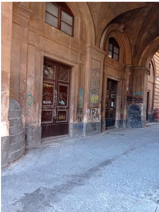
Figura 4. Teatro Massimo «V. Bellini» (CT), costruito su progetto dell'arch. Carlo Sada, inaugurato nel 1890. Particolare di atti vandalici. Foto dell'autrice.
